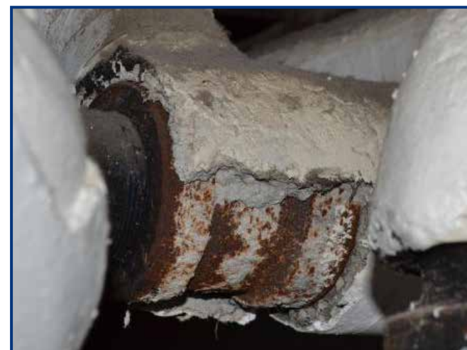
Asbestos Pipe Wrap
